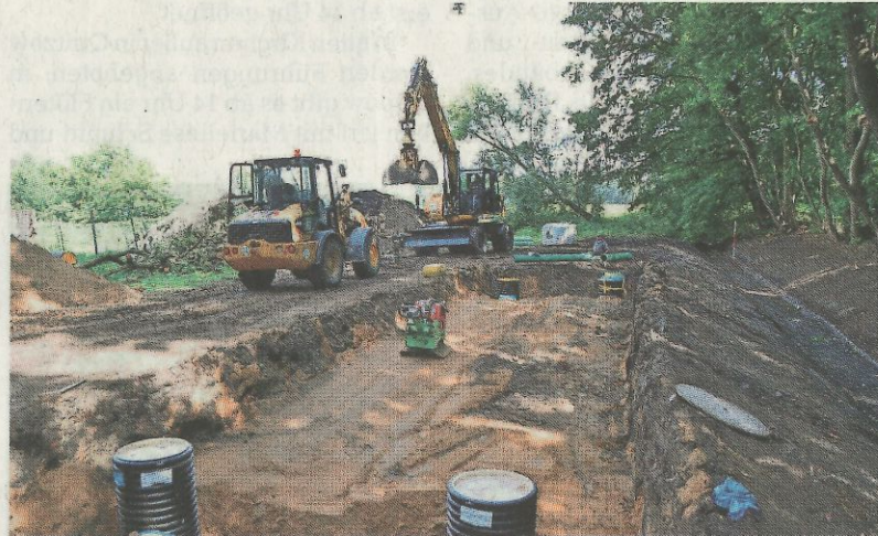
Diese Ansicht wird es schon in wenigen Tagen nicht mehr geben. Die Anlage arbeitet unterirdisch.
